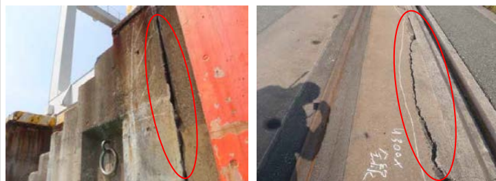
上部工側面の剥離
